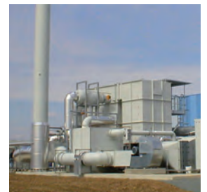
Концентрационные установки с регенеративными дожигательными
