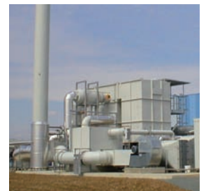
Urządzenie koncentracji zanieczyszczeń z regeneracyjnym urządzeniem dopalania gazu
