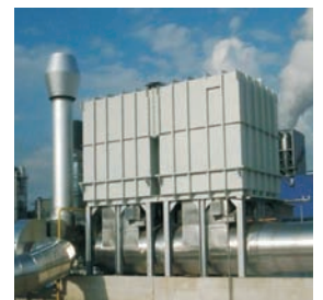
Impianti di post-combustione rigenerativa
