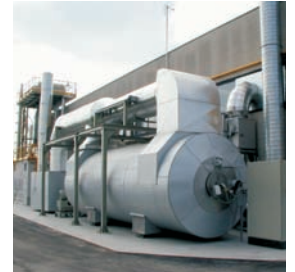
Impianti di post-combustione termica
