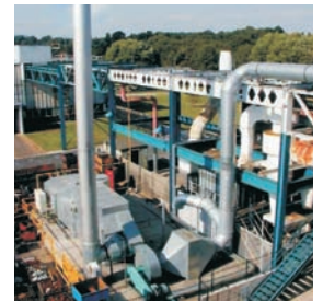
Impianti di post-combustione catalitica
