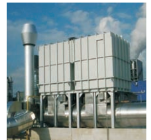
Postcombustion thermique avec régénérateur
