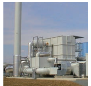
Las plantas de concentración, en combinación con oxidación térmica
