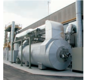
Oxidación térmica recuperativa
