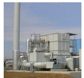
Aufkonzentrationsanlage mit regenerativer Nachverbrennungsanlage
