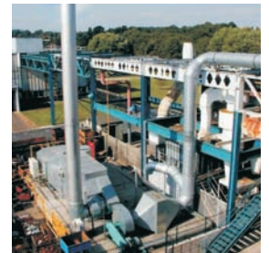
Zařízení pro následné katalytické spalování
